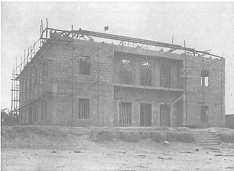
Foto 41 — Construção do Edifício dos Paços do Concelho (1936) no local da Fábrica de Refrigerantes Capela.
