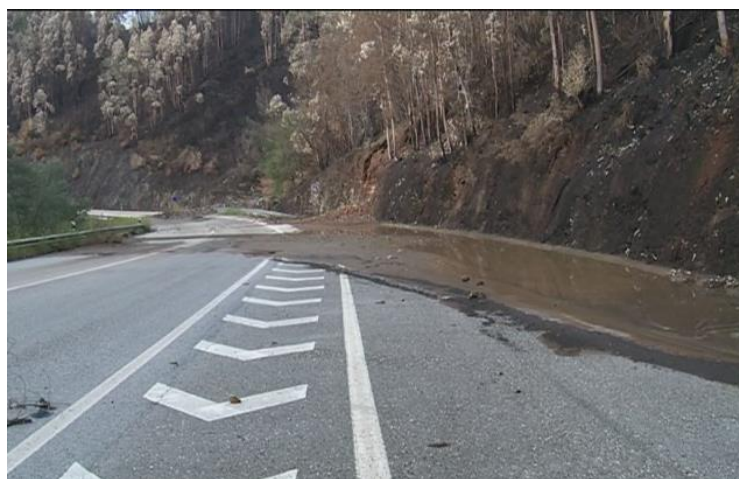
Imagem 24. Estrada da Beira, Coimbra - Áreas de instabilidade de vertentes
