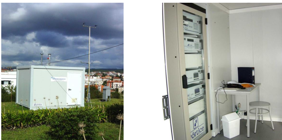
Figura 2 - Estação de monitorização da qualidade do ar de Coimbra/Instituto Geofísico, vista do exterior e interior do abrigo
