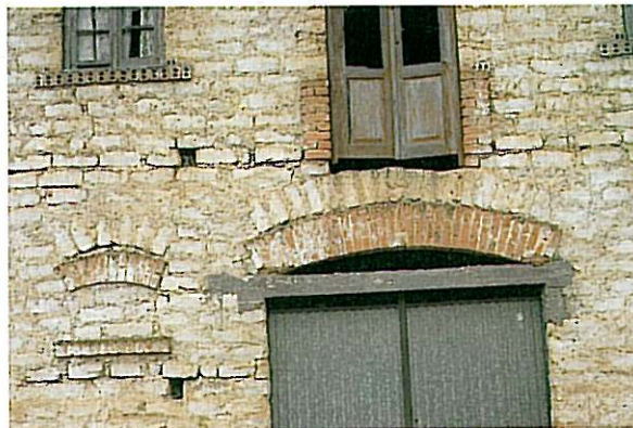
Fig. 13 - Protecção dos lintéis com arcos de tijolo burro e adobe.
